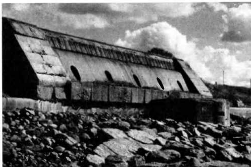
Броневой бруствер конструкции инженера Шведе. Форт «Константин». Фотография Е. И. Образцова. 2002 г.
